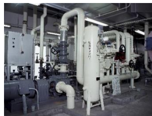
ビルの空調設備
