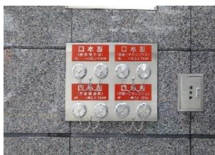
消火栓送水口
