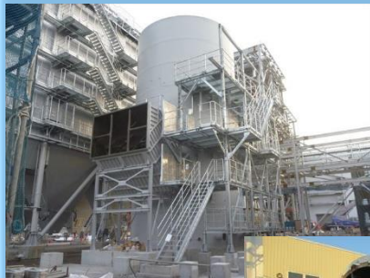
富洋で製作した 排煙脱硫塔
